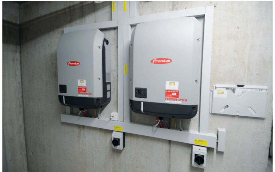
Ins technische Netzwerk sind auch die Wechselrichter der PV-Anlage integriert.
